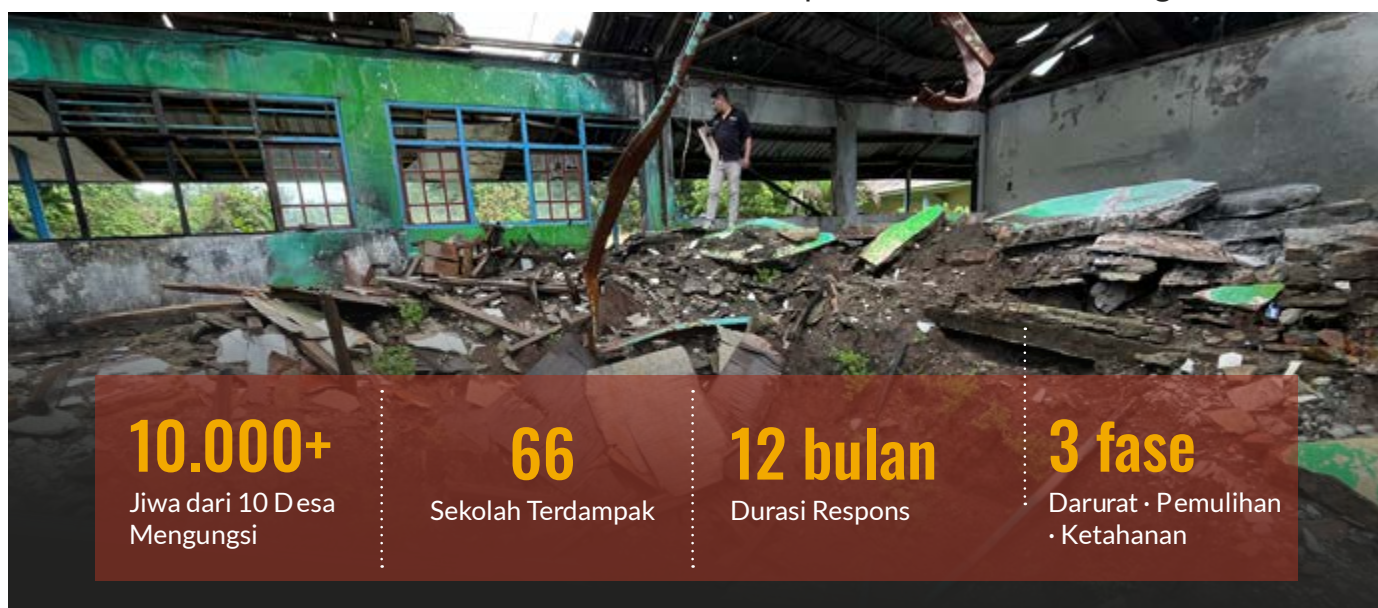
▲ Kondisi ruang kelas yang terdampak erupsi Gunung Lewotobi Laki-Laki.
